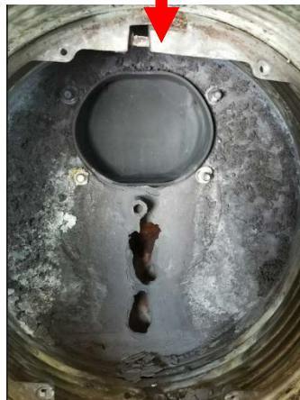
Corrosion accélérée sur la plaque arrière en aluminium de l'échangeur thermique
